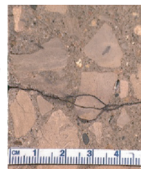
Détection de l'ouverture de microfissures dans le béton
