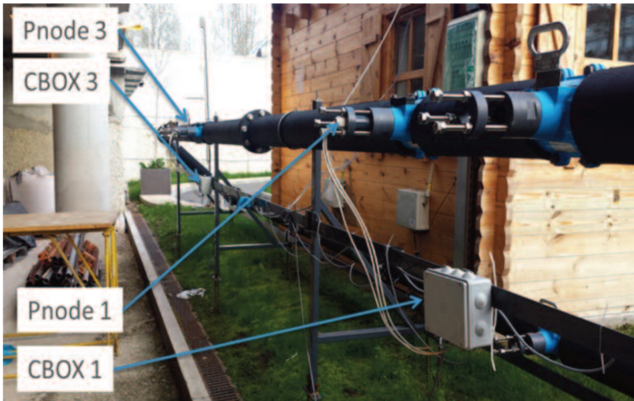
Capteurs Proteus (Pnode) déployés dans le réseau d'eau potable Sense-City, avant que celui-ci ne soit enterré dans le sous-sol de la 1re mini ville
